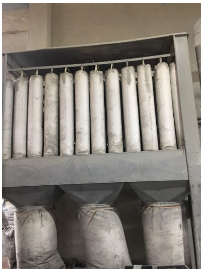
Fotografía 9. Filtro de mangas
