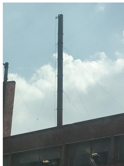
Fotografías 10. Ducto del horno de extrusión
